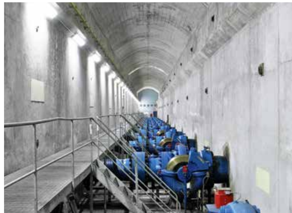
Chambre des vannes, usine de Nendaz
