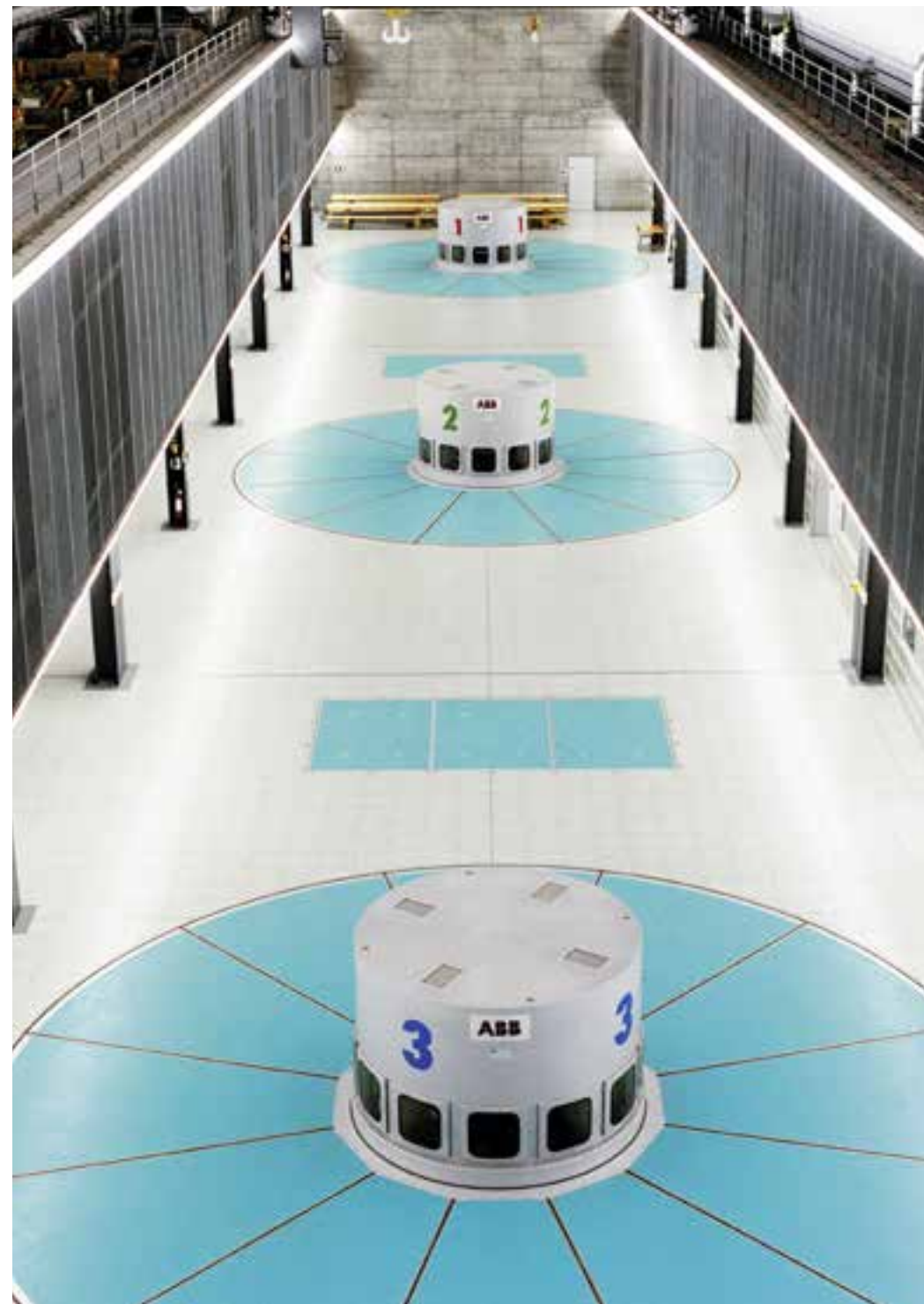
Salle des machines de l'usine de Bieudron
