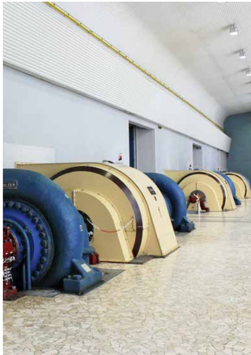
Salle des machines de la station de pompage d'Arolla
