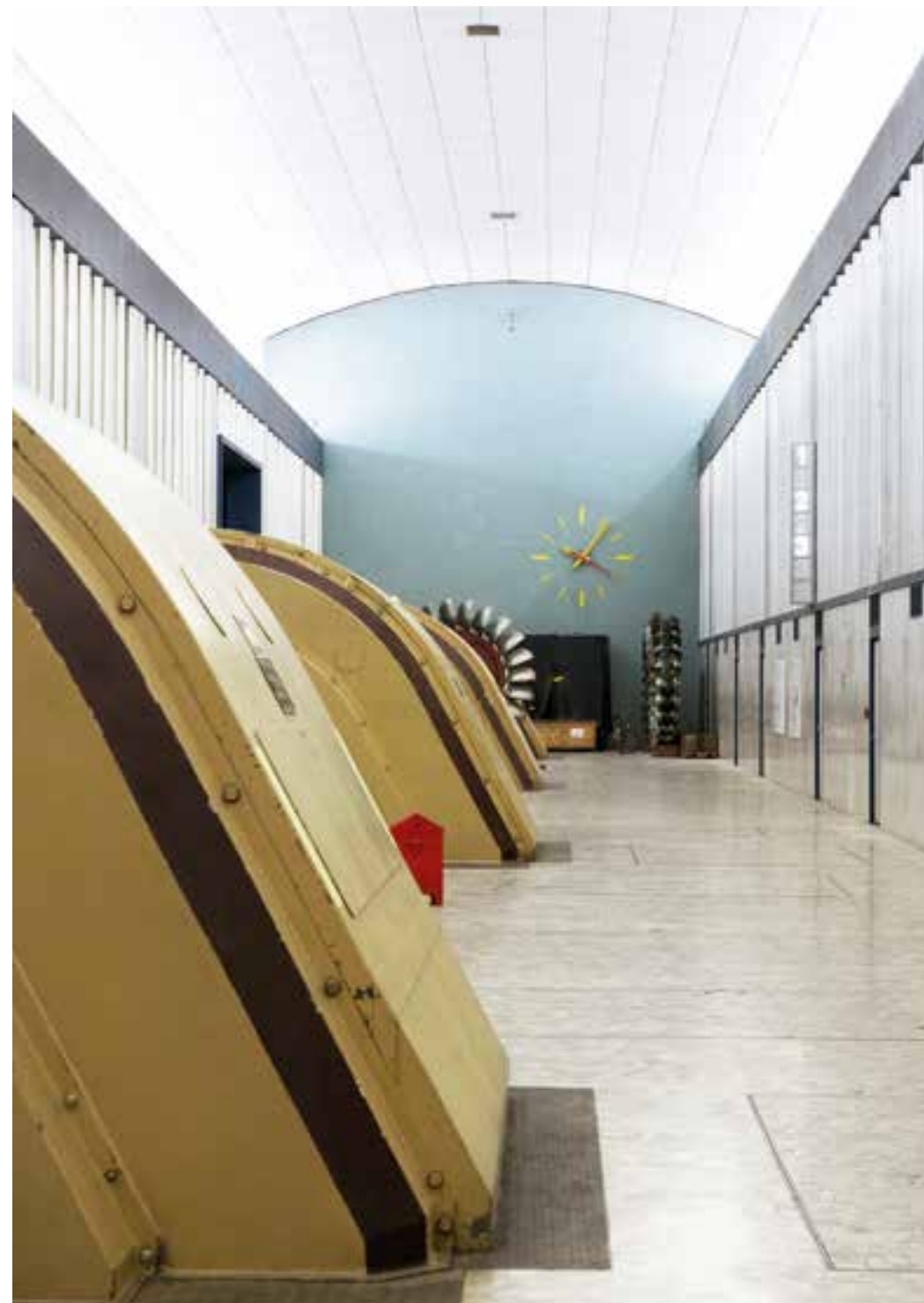
Salle des machines de l'usine de Nendaz
