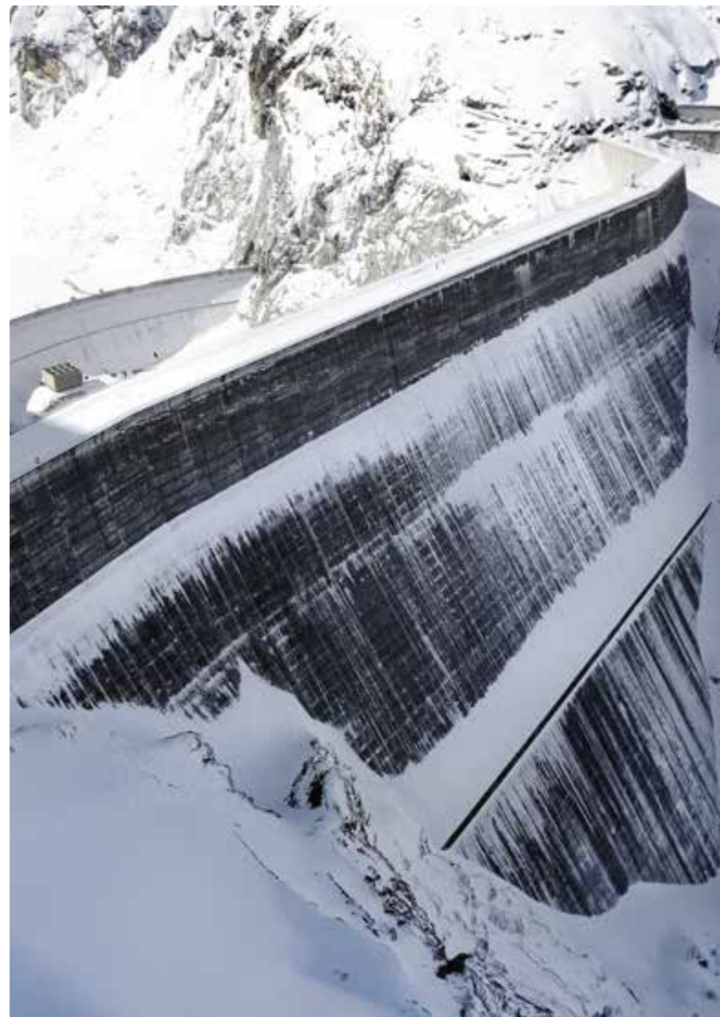
La Grande Dixence et le barrage de la première Dixence (à gauche), submergé en temps normal par le Lac des Dix
