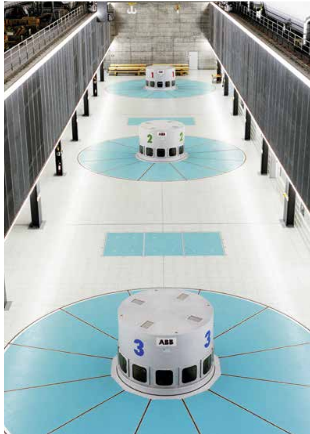
Maschinenraum des Kraftwerks Bieudron
