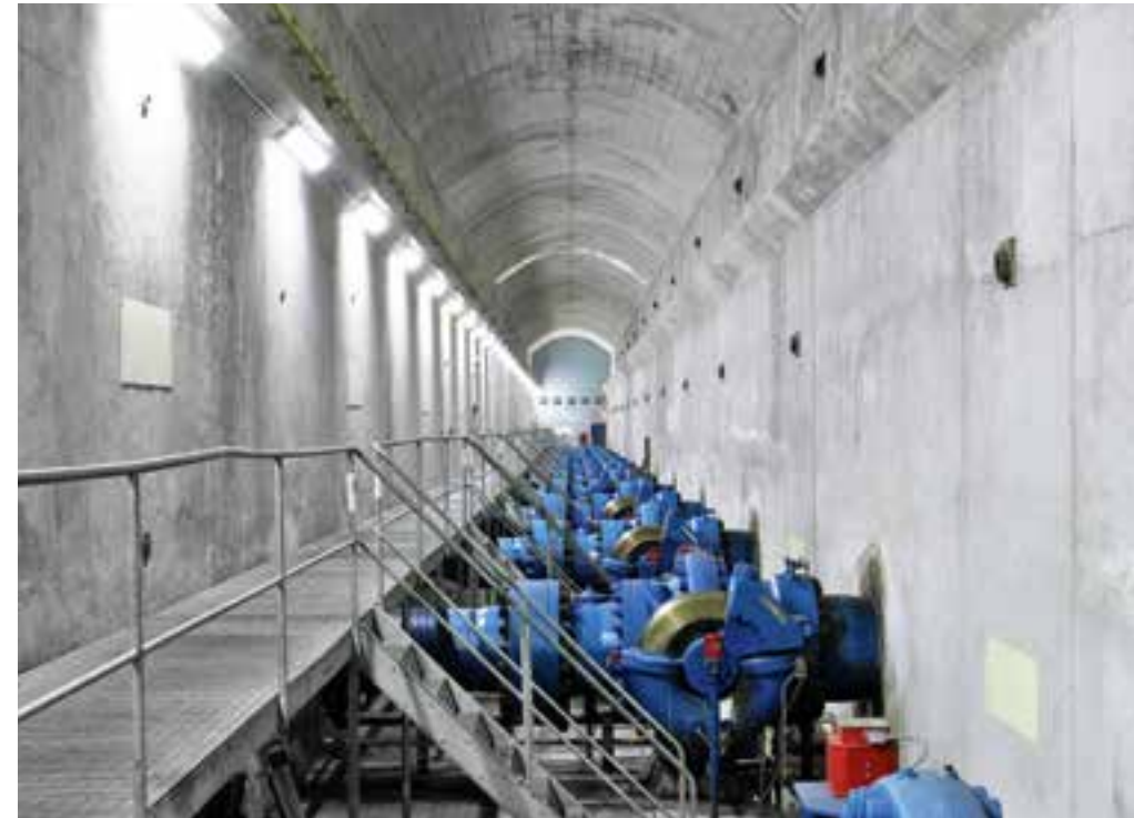
Schieberkammer, Kraftwerk Nendaz
