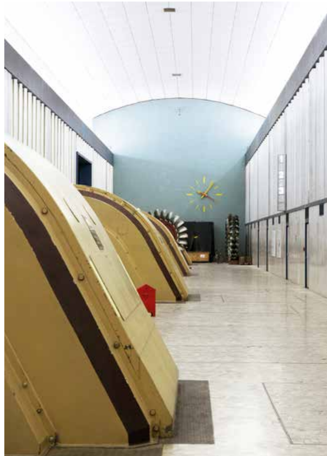
Maschinenraum des Kraftwerks Nendaz
