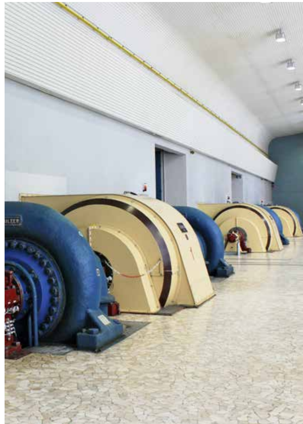
Maschinenraum der Pumpstation Arolla
