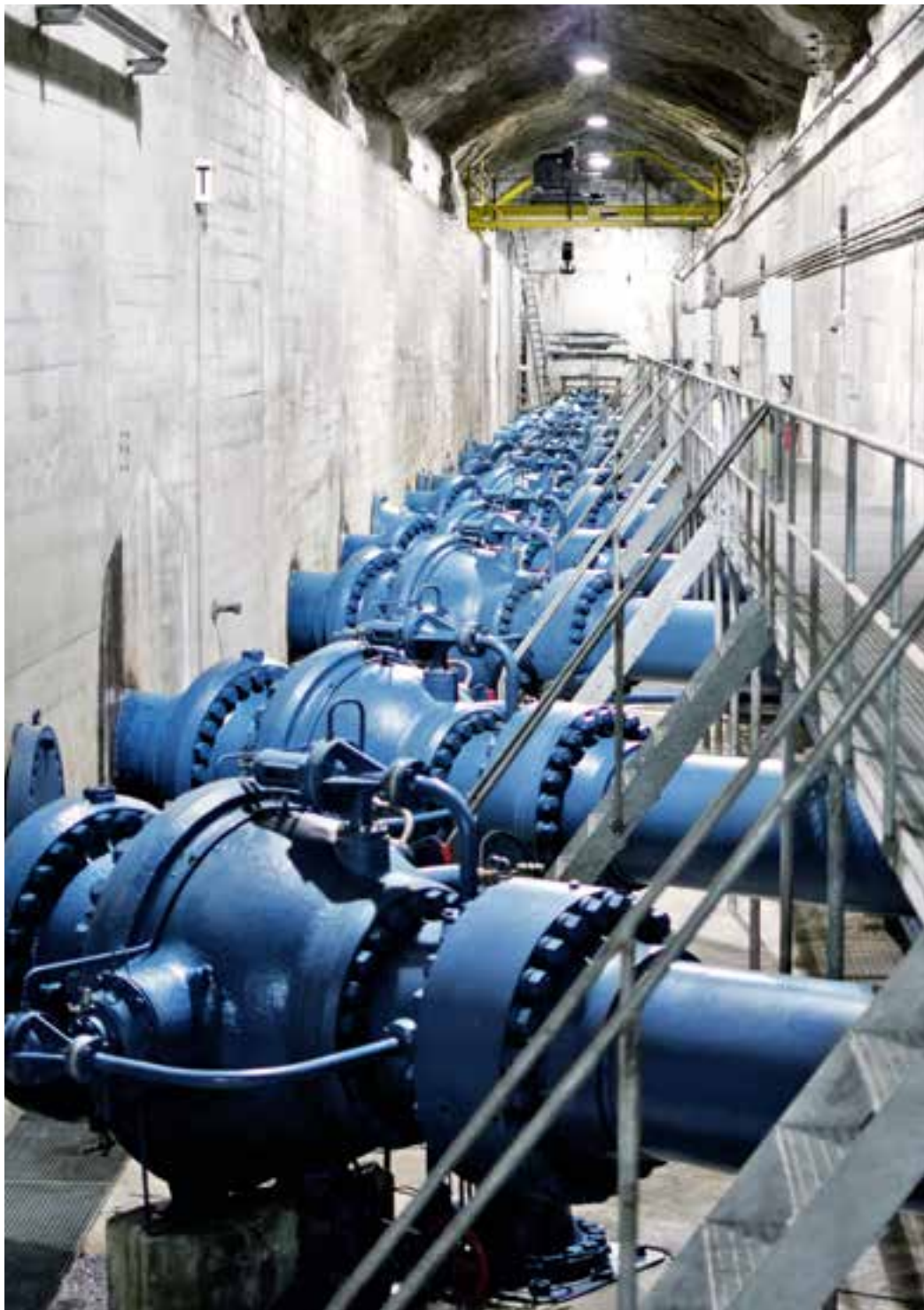
Schieberkammer, Kraftwerk Fionnay
