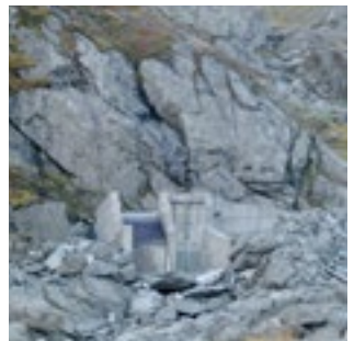
Detail der Wasserfassung.
